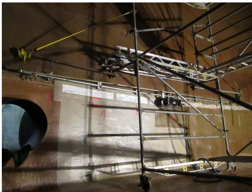
Bild 9. Das Magnetverfahren innerhalb eines Spannbetontankbehälters zur Messung der horizontalen, ringförmig verlaufenden Spannglieder auf Rissefreiheit.
